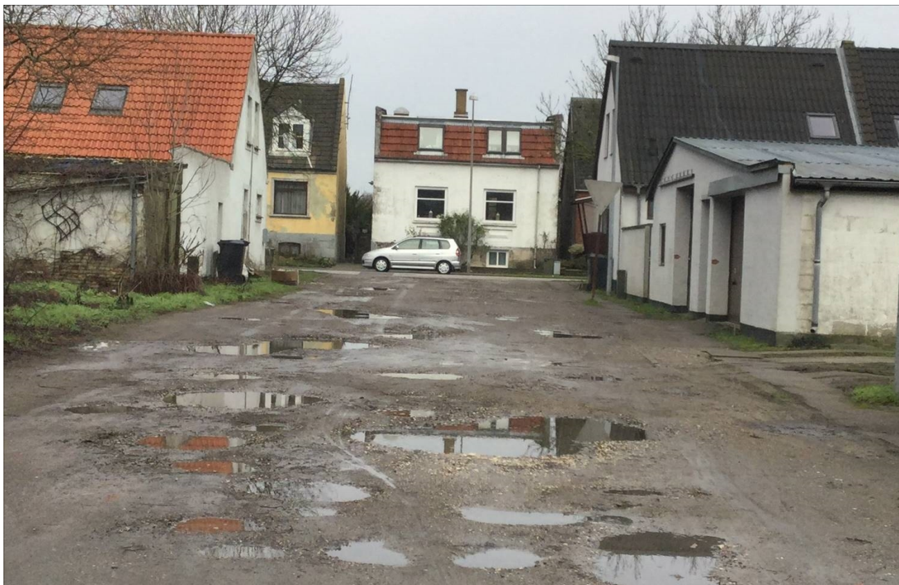
Foto: taget af Park og vej, Ujævn til hullet grusvej - Otto Kuldsvej Nakskov, 2019
