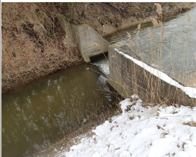
Figur 4: Styrt på Lilleholms Kanal (3L) (st. 11548m) umiddelbart før Lilleholm Kanals udløb i hovedkanal (39L).
